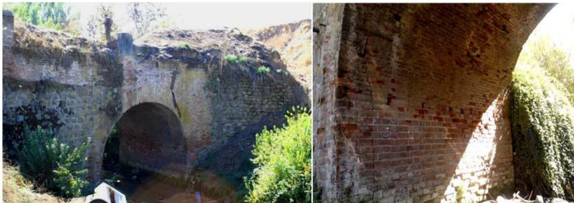
Situación actual del Puente El Peral. La gran bóveda y los cimientos de piedra entre la vvegetación que causa años de abandono. Fotografía 2011
