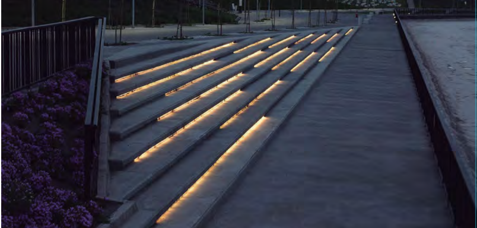
LUMINARIAS EN PELDAÑOS, PARQUE FLUVIAL PADRE RENATO POBLETE, QUINTA NORMAL, SANTIAGO
